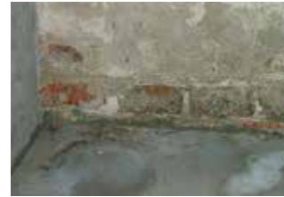
Nedvesség okozta károsodás a pincében
